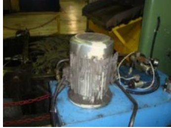
Soğutma Kulesi Motoru
